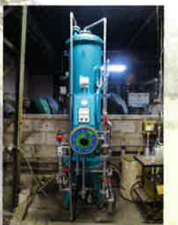
純水製造装置
