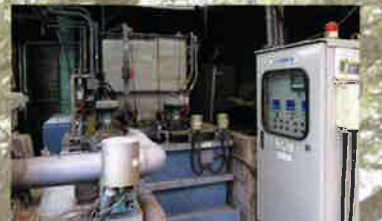
排水処理施設
